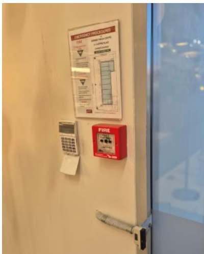
E15 – Automatic door sensor and alarm
