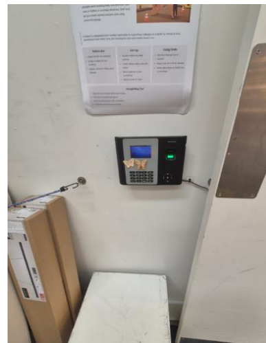
E16 – Block A & B Door intercom
