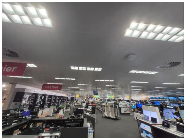
E10 – Block A & B lighting
