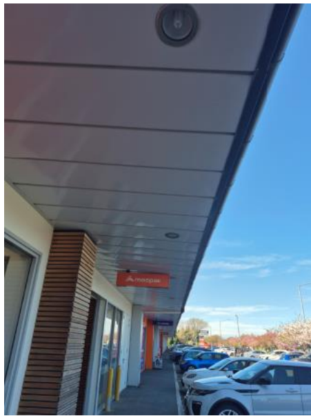
E7 – Exterior lights
